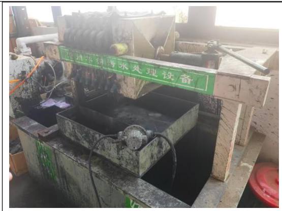
图 3-2 项目废水处理设施
