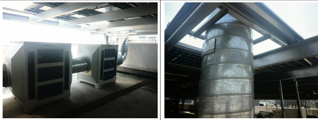
图 3-3 项目废气处理设施及排放口
